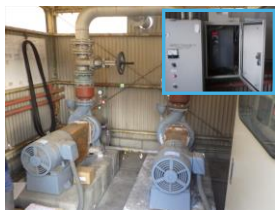
循環ポンプのインバータ (秦野事業所)
